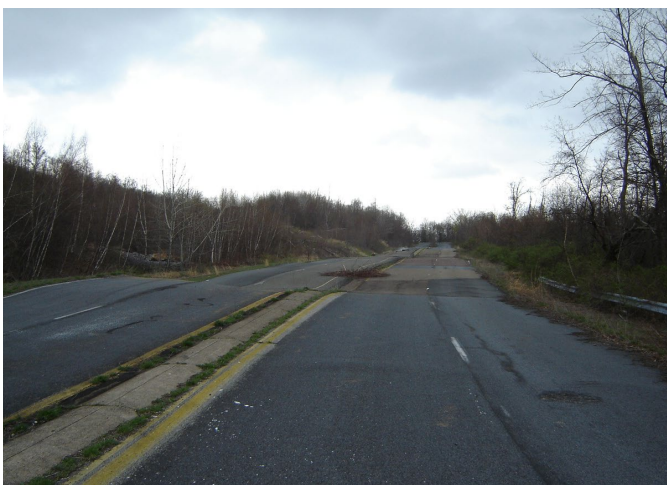
Rys. 1. Przykład zdeformowanej nawierzchni drogi „The buckled roadway” by Douglas Muth, licensed under CC BY 2.0
