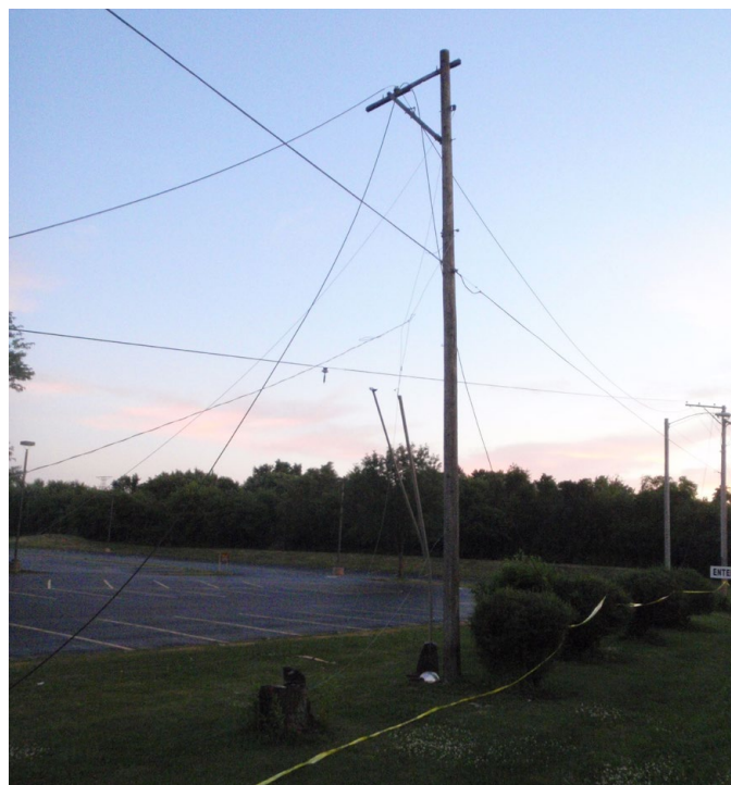
Rys. 1. Przewrócony słup linii elektroenergetycznej.
